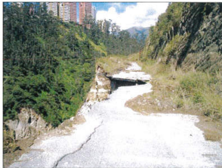
Figura 24. Deslizamiento de la vía debido a la constante erosión en la ladera inferior.
